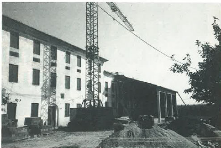
La nuova tettoia è pronta per il lavoro di copertura e per la costruzione di tre archi fra i quattro pilastri.
